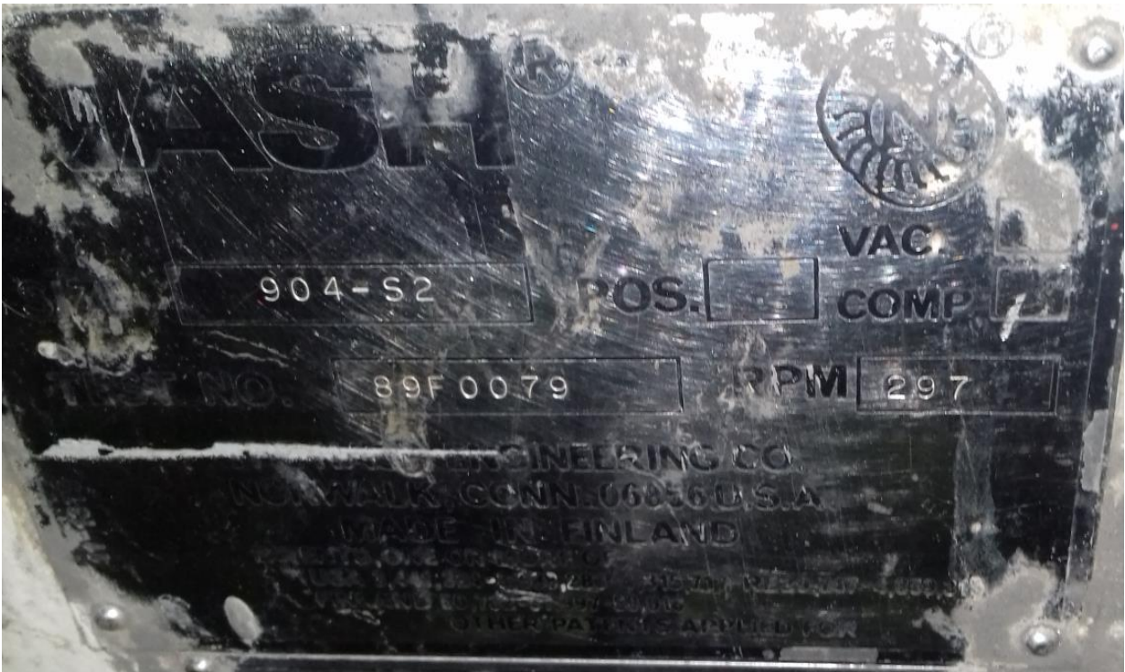
Вакуумнасос №4 , Поз.6761P6424 Марка 904- S2
